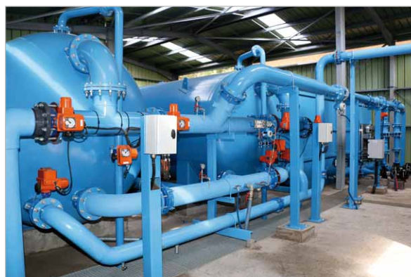
L'usine de traitement des eaux de Haumi.
