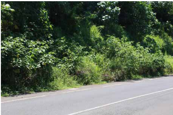
Accotement entre le PK20 et 21 à Atiha la végétation cache les caniveaux
