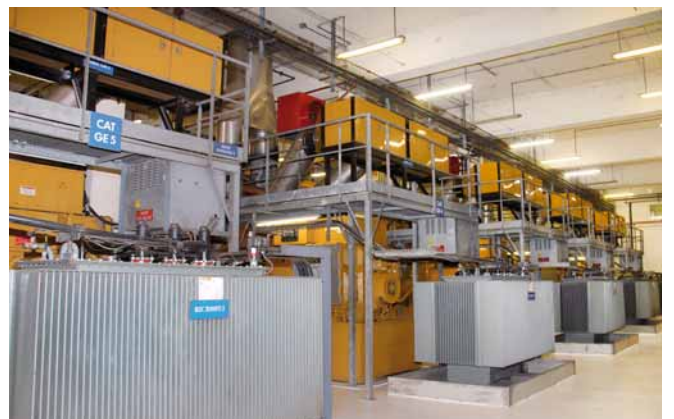
Les moyens de production thermique de la centrale de Vaiare : 5 groupes électrogènes d'une puissance unitaire de 3,3 MW
