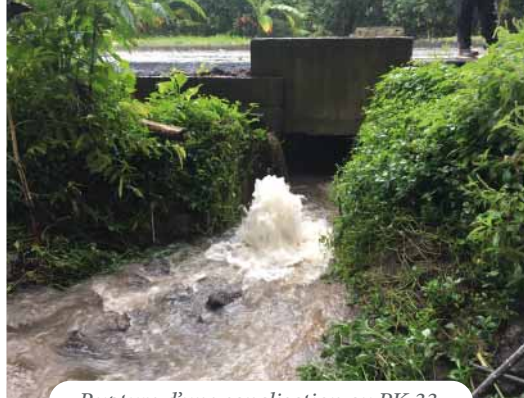
Rupture d'une canalisation au PK 33
