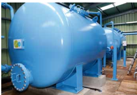
L'usine de traitement Unité Compacte Degrémont (UCD) "Te Maoe" est en service depuis le 1er juillet 2017.
