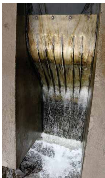
Le captage de Papetoai est équipé d'un grille de filtration Coanda* * Du nom de l'ingénieur à l'origine de la découverte de cet effet physique : Henri Coandă.
